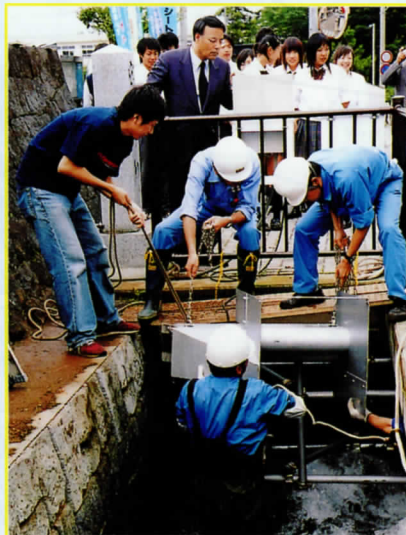
全国で初めてとなる河川(家中川)を利用したサボニウス型水車によるマイクロ水力発電の実験が開始されました。発電量の計測は谷村工業高等学校の生徒があたり、実用化に向けての研究が進められます。なお、水車にごみが付着すると発電量が落ちるため、川にごみを捨てないようお願いいたします。
